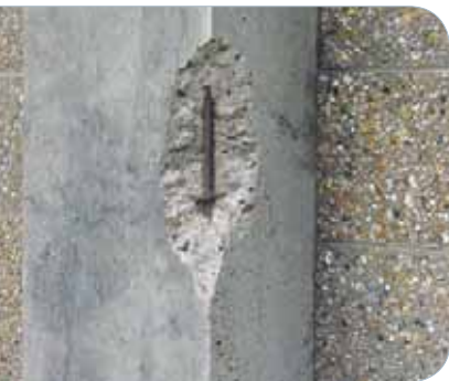
Corrosion des armatures
