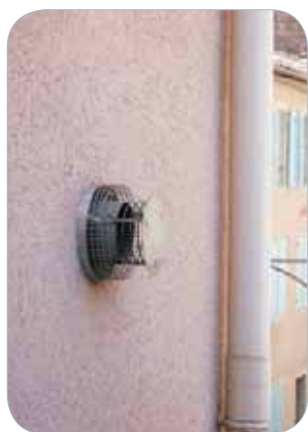
Ventouse de chaudière
