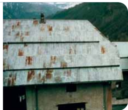
Couverture en acier corrodée
