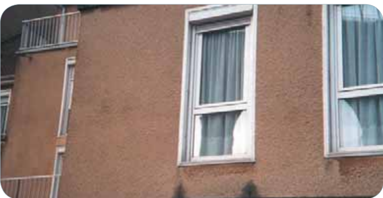
Salissures d'un enduit hydraulique
