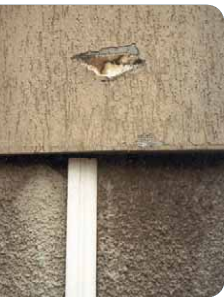
Choc dans un enduit sur isolant
