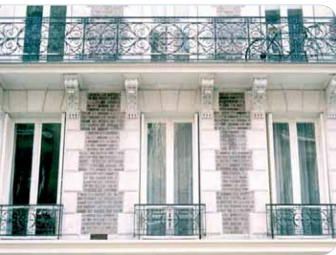
Garde-corps en fer forgé
